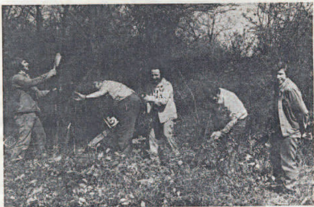
Mitglieder des FC Neuenburg trafen sich jetzt, mit Säge und „Hauen“ bewaffnet, und zogen in Richtung Rheinwald, wo das neue Sport- und Freizeit-Zentrum entstehen soll. Eine große Planieraube stand bereit und bahnte einen Zugang durch das Unterholz zu der zur Rodung ausgesteckten Stelle. Im Laufe des Vormittags wurde eine größere Fläche gerodet. Viele Arbeitsstunden im Wald werden noch nötig sein, um mit den ersten Erdarbeiten am Sportzentrum beginnen zu können. Am kommenden Samstag wird die Arbeit fortgesetzt. Helfer sind willkommen. Bild: Mäster
