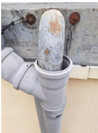
Nicht abgedichtete Fallrohre
